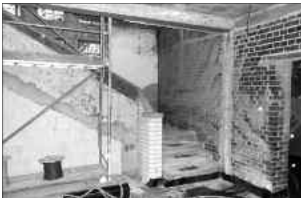
Ein „Zeitfenster“ verschwindet. Aufnahme zum Med.-Punkt: 2009 mit Ausnahme der Scheiben noch erhalten, Entkernung Anfang 2010, Zustand Ende 2010. Fotos: Virtuelles Museum Proraer Bausoldaten.
