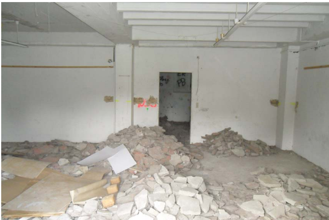
Blick in die Poststelle. Das Parterre wird auf KdF-Bad-Struktur zurückgebaut und darin das Bad erläutert. Das zweite und dritte Geschoss soll zum Saal werden, darüber soll an die Bausoldaten erinnert werden (so die Absichtserklärung).
