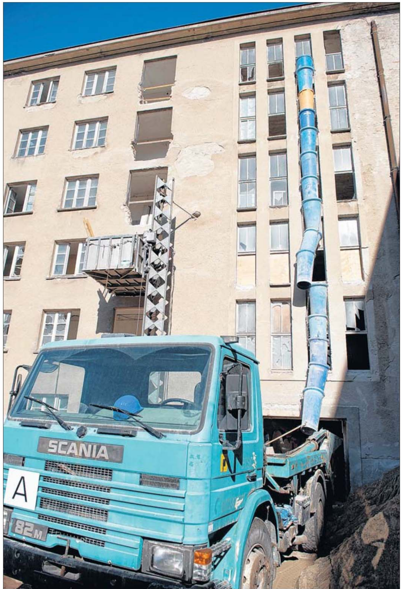
Ein Baufahrzeug vor Block II des einstigen „KdF“-Seebads Prora im Ostseebad Binz.
