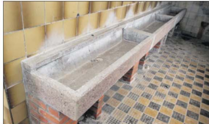
Zu DDR-Zeiten waren auch Bausoldaten in Block V stationiert. Die Waschräume aus dieser Zeit sind zum Teil erhalten geblieben.
